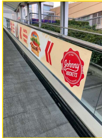
Scala mobile ingresso ovest
