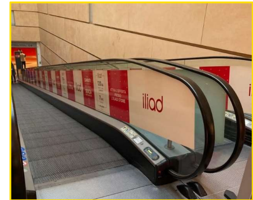
Scala mobile ingresso sud
